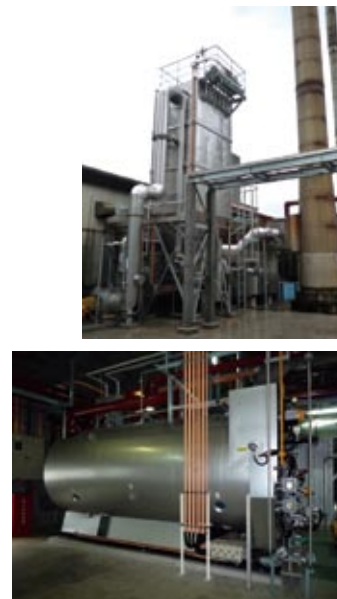
廃油の燃料化設備
