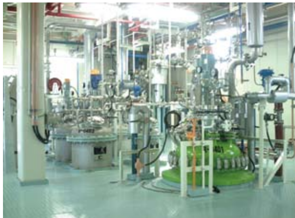
平成21年1月に完成したパイロットプラント設備
